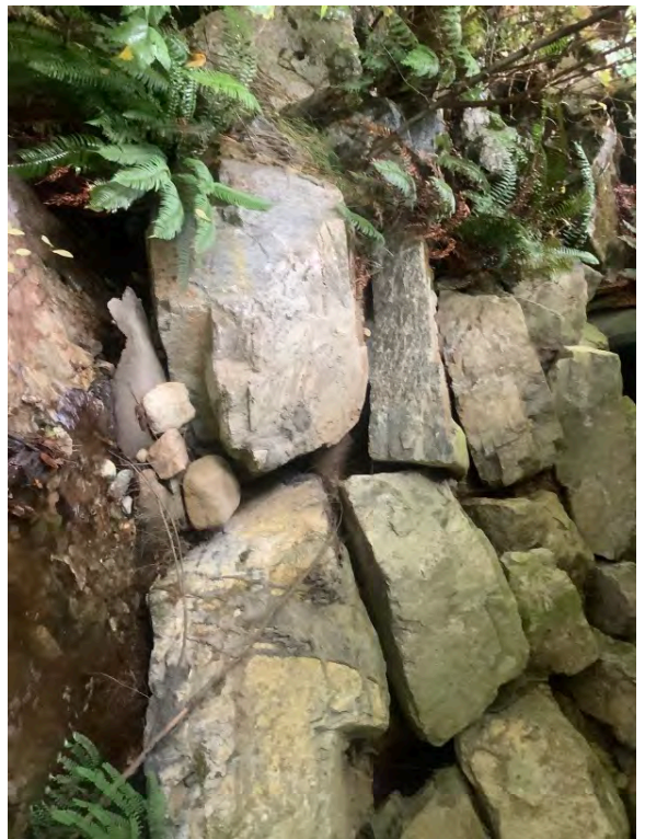
Ds right riprap scour
